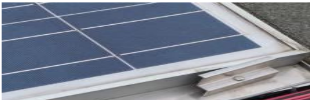
Figure 39 : Les éventuelles fuites à travers les défauts d'isolation
