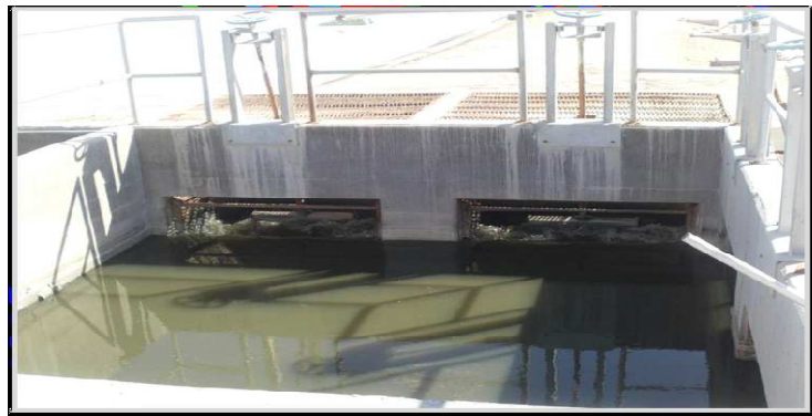
Fig. 10 - Ouvrage de répartition de la STEP.
