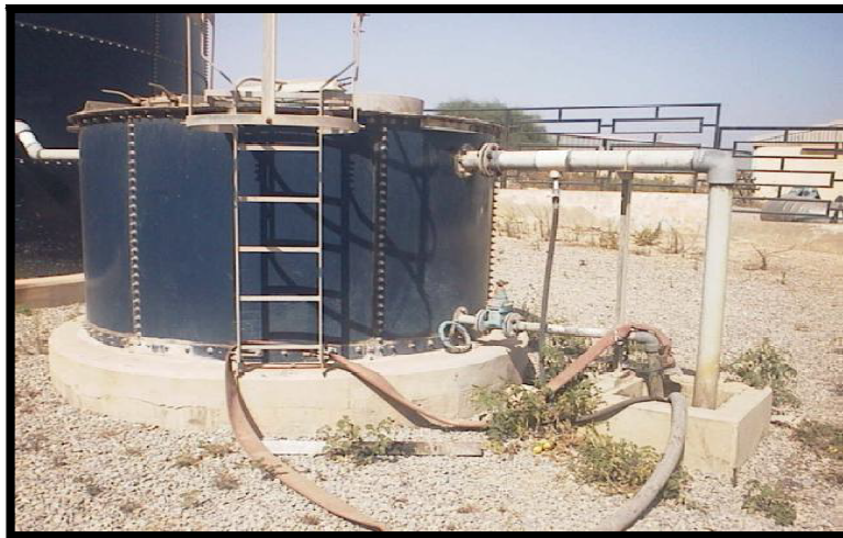
Fig. 24 - Bassin d'aération et dénitrification de la STEP.
