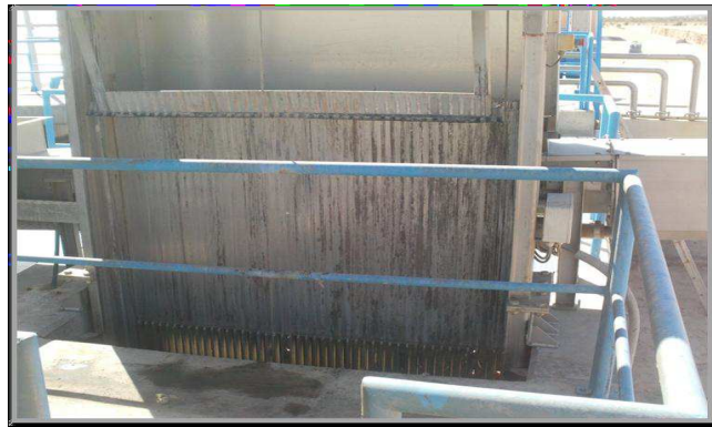
Fig. 7 – Dégrilleur de la STEP.
