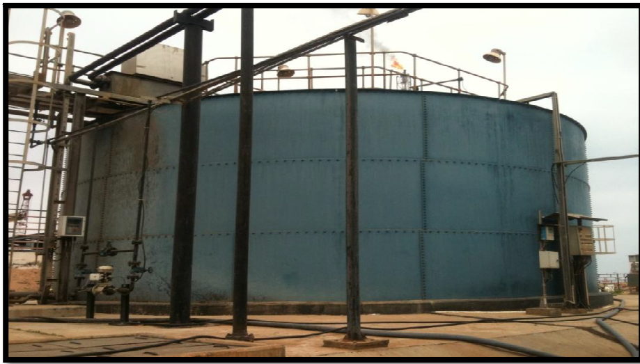
Fig. 16 - Bassin du traitement biologique de la STEP.
