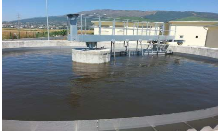
Fig. 13 - Pont Décanteur Circulaire pour les Bassins de décantation de la STEP.
