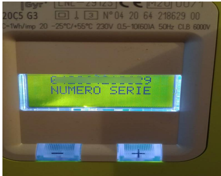
Figure 3 : Compteur Edf Linky [9].
