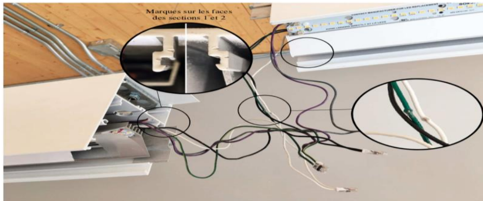
Figure I.12 : Fils pinces et dénudés entre les sections 1 et 2 du luminaire lors de l'assemblage
