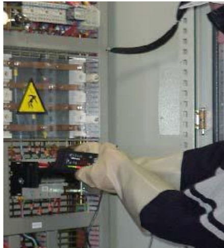
Figure III .6 : opère à moins de 30 cm de pièces nues sous tension.
