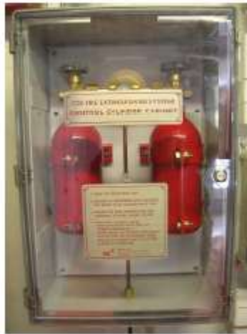
Figure 5.5 : Armoire de contrôle de libération du système CO 2
