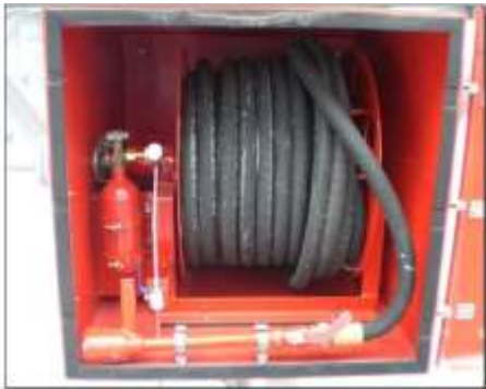
Armoire à tuyaux pour poudre sèche pour pont
