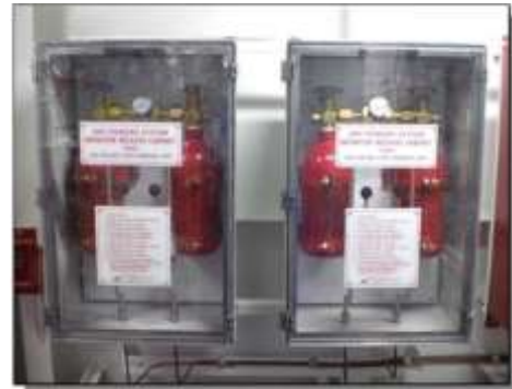
Cabinet de libération du moniteur du système de poudre sèche
