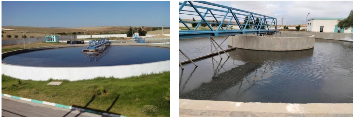
Figure III.13: Décanteur secondaire (Keddar et Mankouri, 2021).
