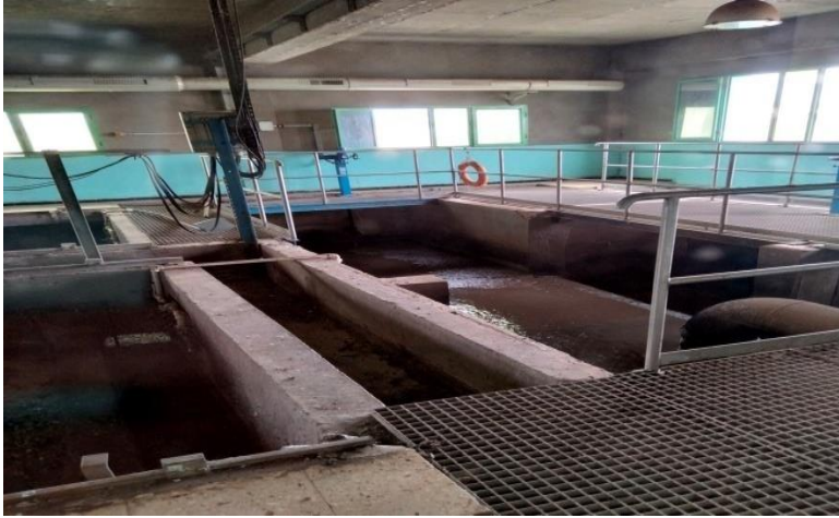
Figure III.11 : Dessableur –déshuileur (Keddar et Mankouri, 2021).
