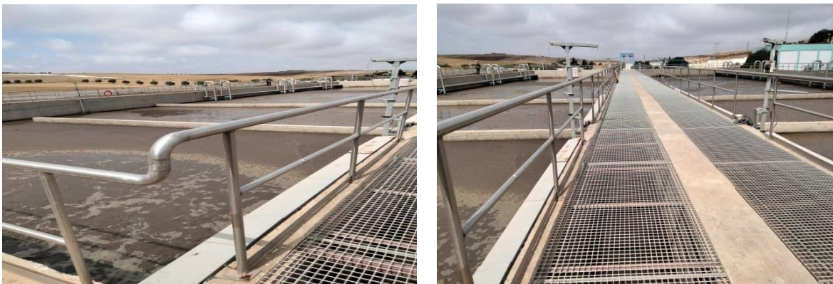
Figure III.12 : Bassin d'aération (Keddar et Mankouri, 2021).
