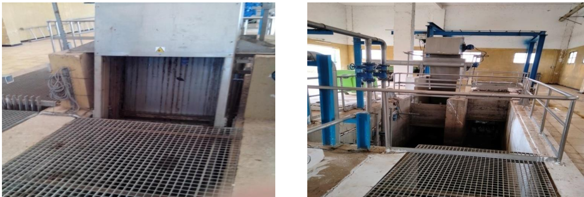
Figure III.5 : Grille mécanisée grossière (Keddar et Mankouri, 2021).
