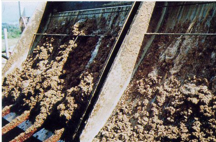
Figure II.1: Photo d'un dégreilleur (Degremont, 1978).
