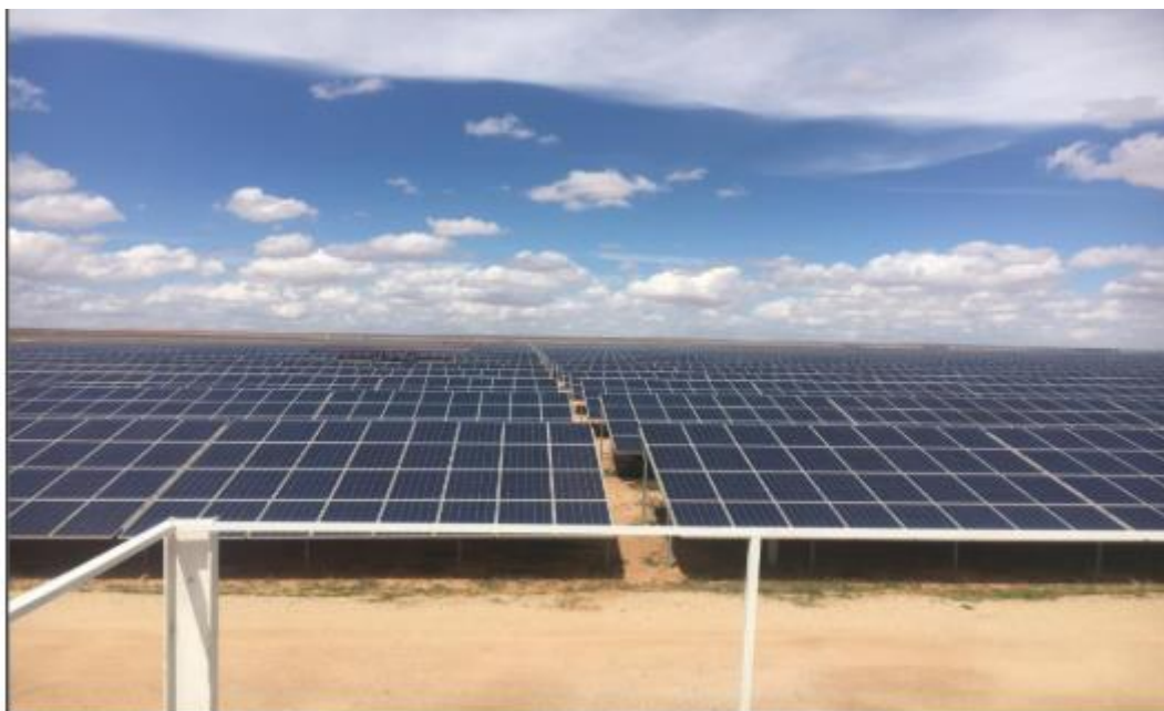
Image 4 Les champs Photovoltaïque de centrale Ain sekhona
