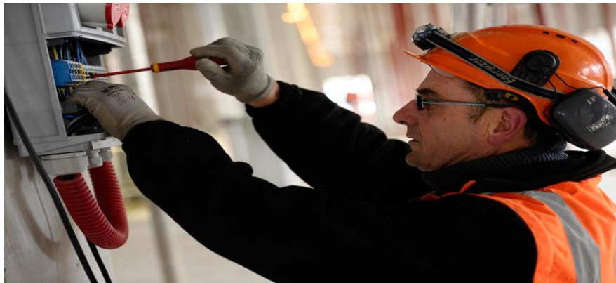
Figure 1: Accident d'origine électrique
