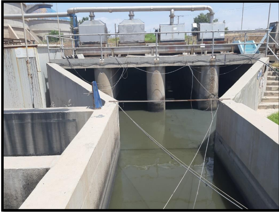
Figure II-5 Les 4 dégrilleurs fins mécaniques.
