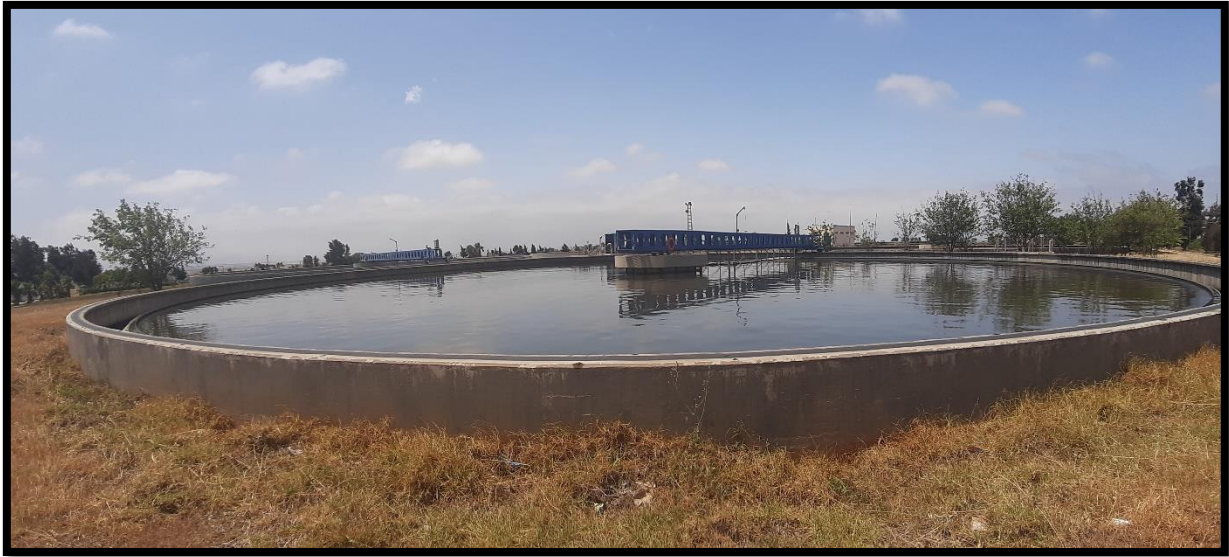
Figure II-8 un décanteur primaire
