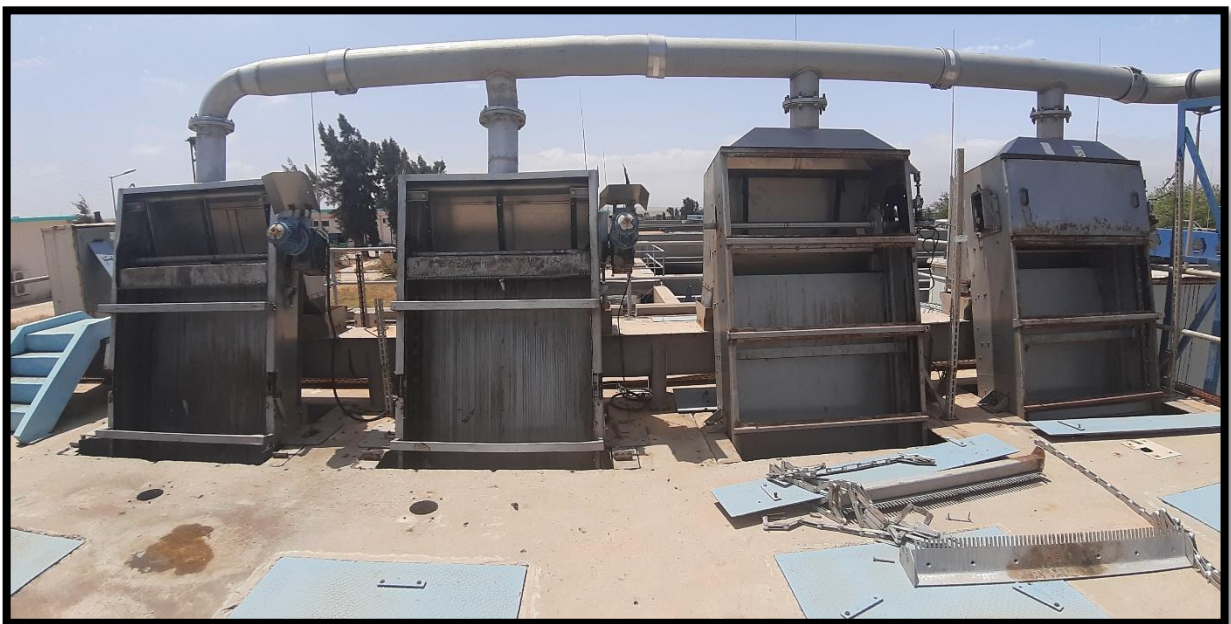
Figure II-4 Les 4 dégrilleurs fins mécaniques.
