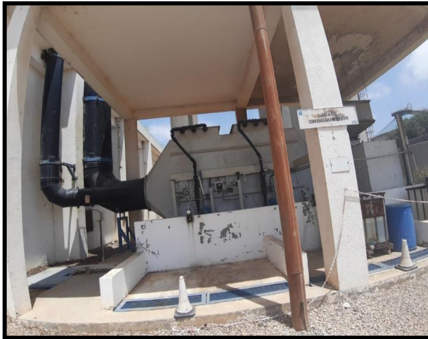
Figure III-2 poste de lavage chimique d'air
