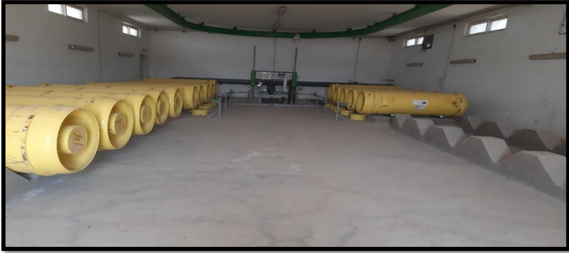
Figure III-3 salle de stockage des tanks
