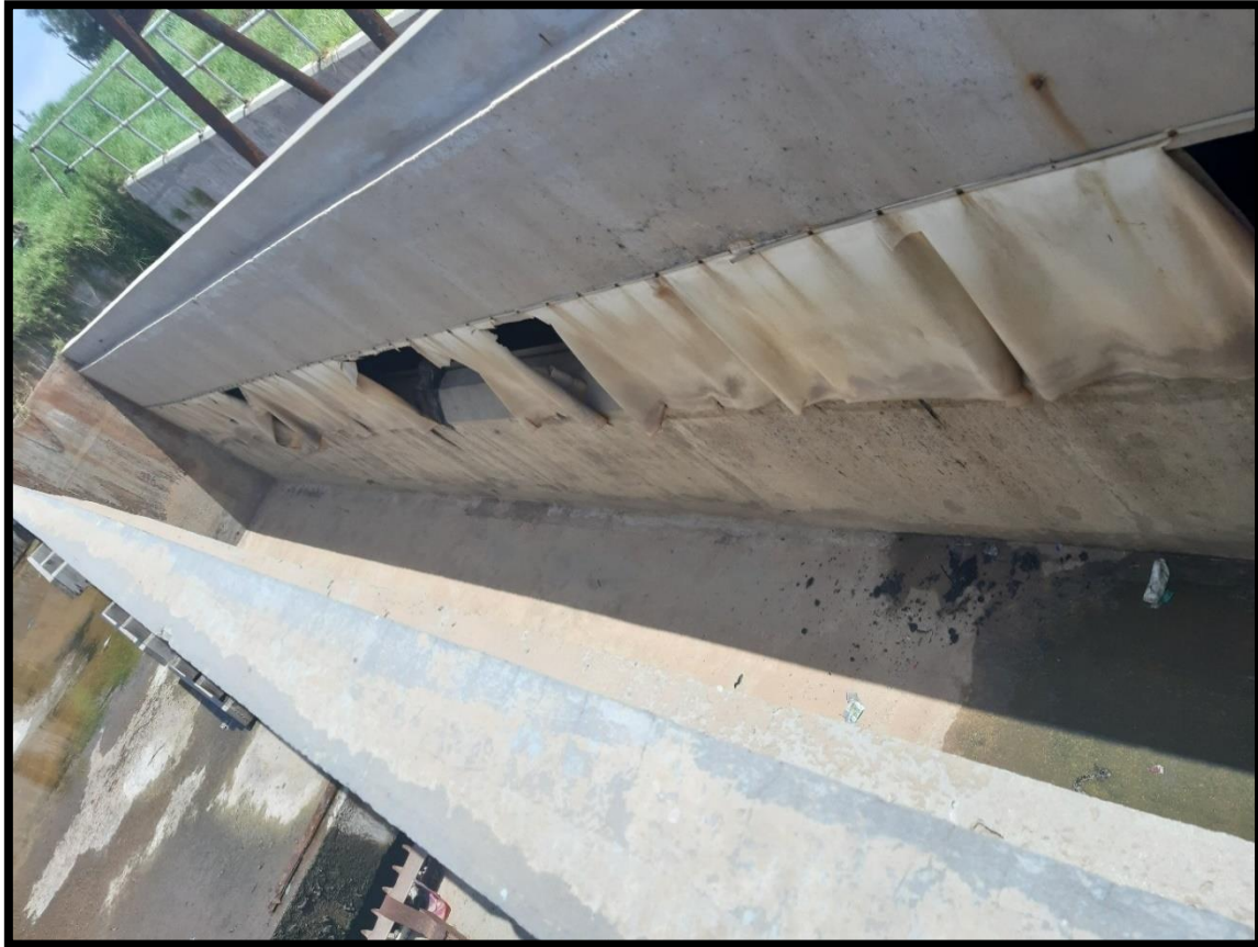
Figure II-3 Déversoir d'orage où by pass général
