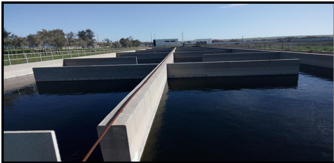
Figure II-12 Bassin de désinfection.
