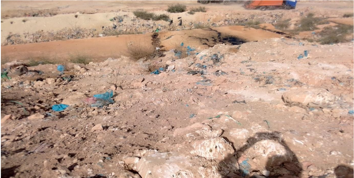
Figure III.23 : l'état du casier 2
