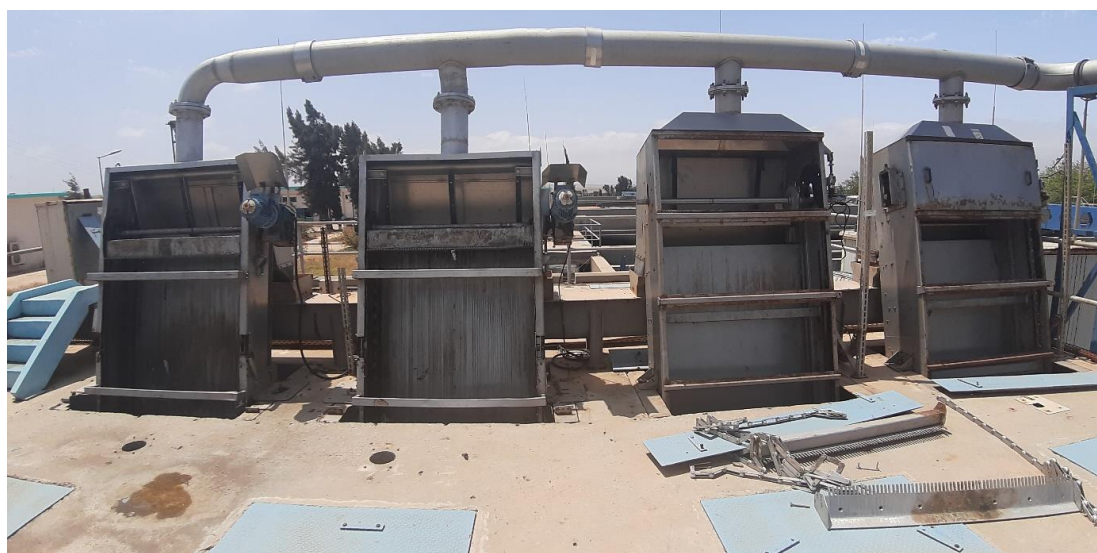
FIGURE III.1 LES 4 DEGRILLEURS FINS MECANQUES.(1)
