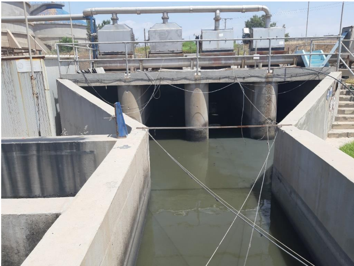
FIGURE III.2 : LES 4 DEGRILLEURS FINS MECANIQUES.(2)
