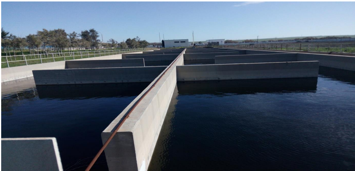
FIGURE III.13 : BASSIN DE DESINFECTION.
