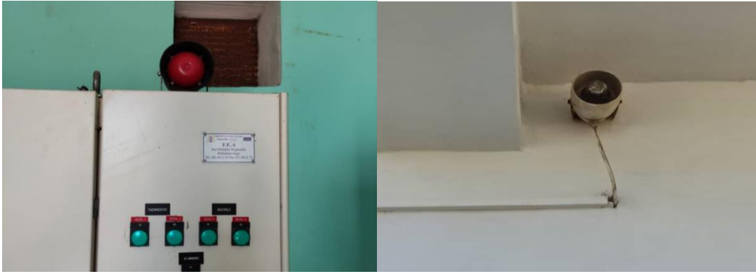
Figure 5. 11 : Alarme de la step
