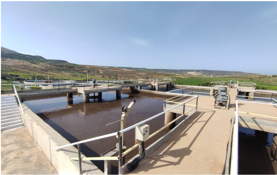
Figure 2. 11 : Bassin d'aération de la STEP.
