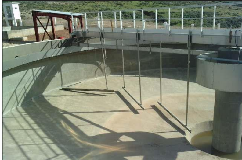
Figure 2. 13 : Clarificateur avec des ponts racleur.
