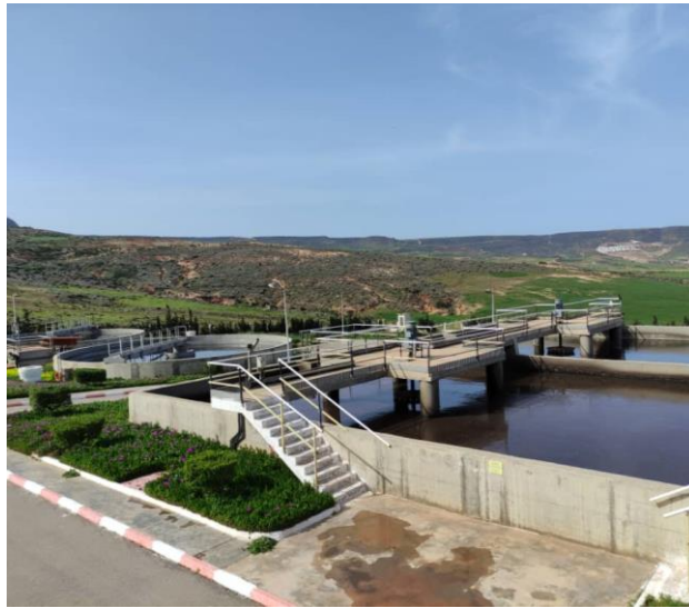
Figure 5. 5 : Exemple de risque de noyade dans la STEP.
