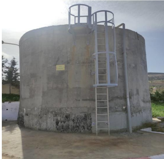
Figure 2. 16 : Silos à boues de la STEP.
