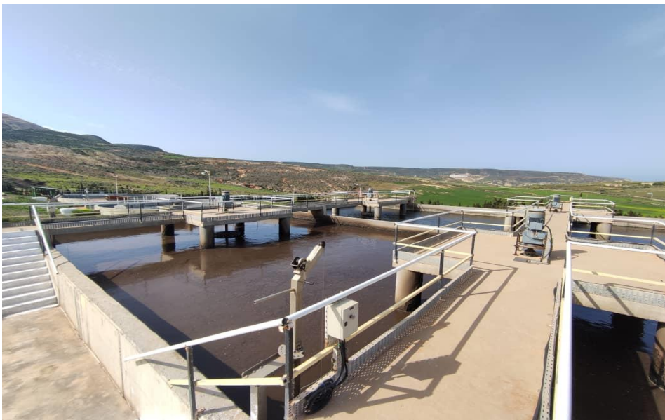
Figure 2. 10 : Bassin d'aération de la STEP.
