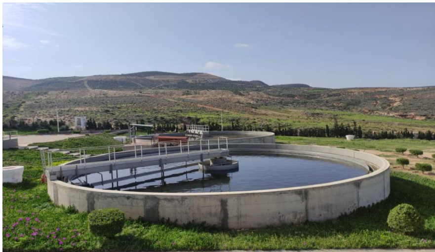
Figure 2. 14 : Clarificateur de STEP.
