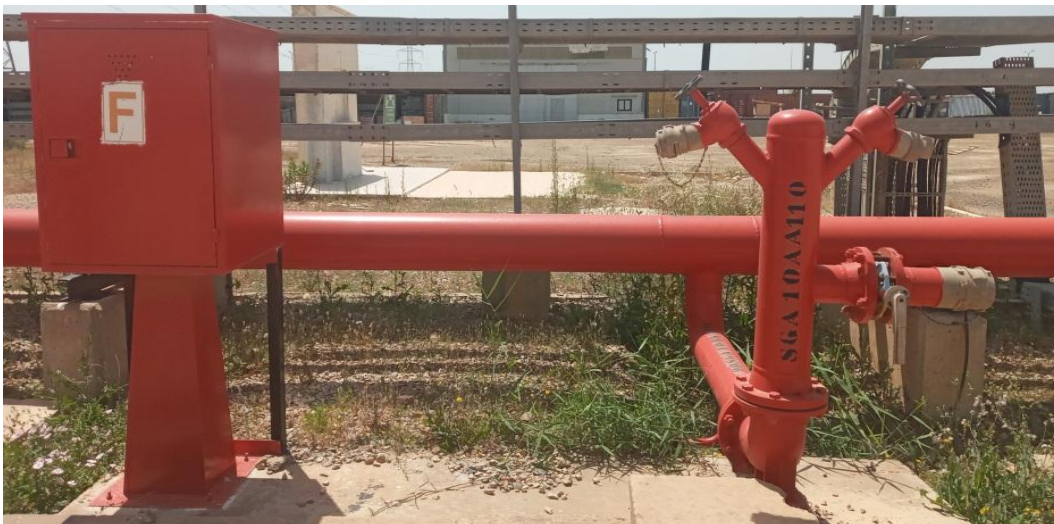
Figure (II. 7) : Poteau d'incendie
