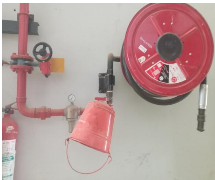
Figure (II. 8) : Robinet d'incendie armé
