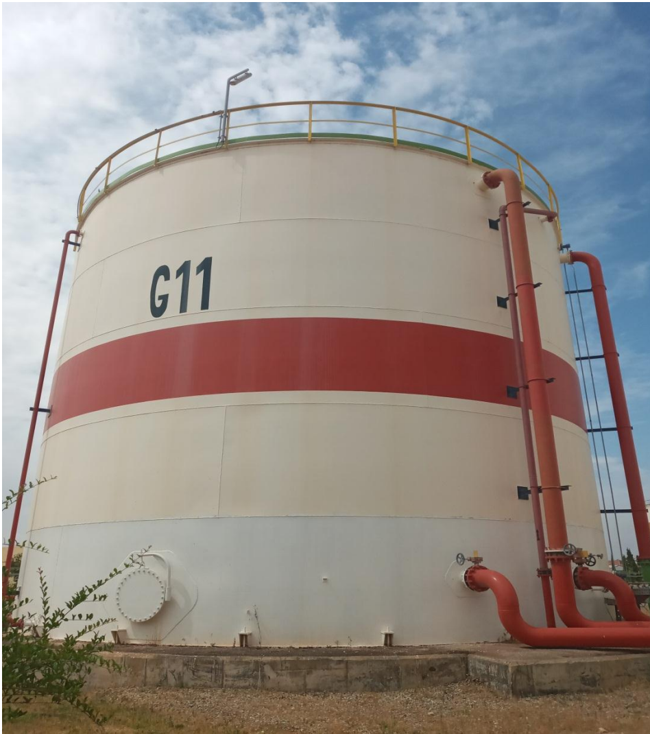
Figure (II.4): Vue du bac de stockage d'eau d'incendie
