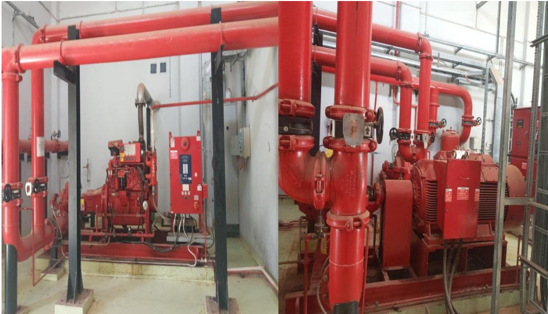
Figure (II.5) : Pompe diesel et Pompe électrique
