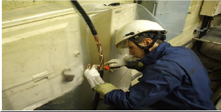
Figure I.34 : Travail sous tension dans un sous-sol I-2-1-2. PAR CONTACT INDIRECT
