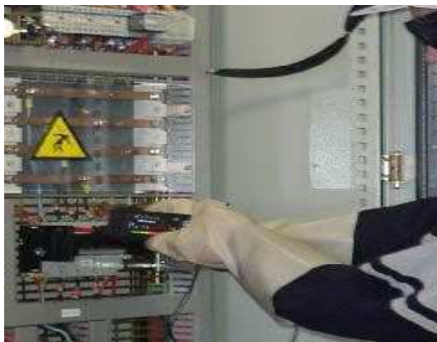
Figure II .70: opère à moins de 30 cm de pièces nues sous tension.
