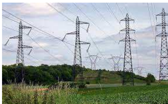
FigureI-8 : Les lignes à haute tension véhiculent l'électricité.
