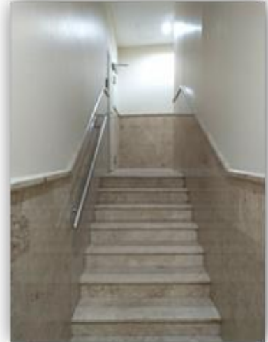
Figure 22 : éclairage de la cage d'escalier.
