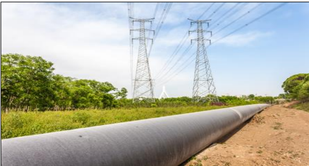
Figure 1 : canalisation des hydrocarbures
