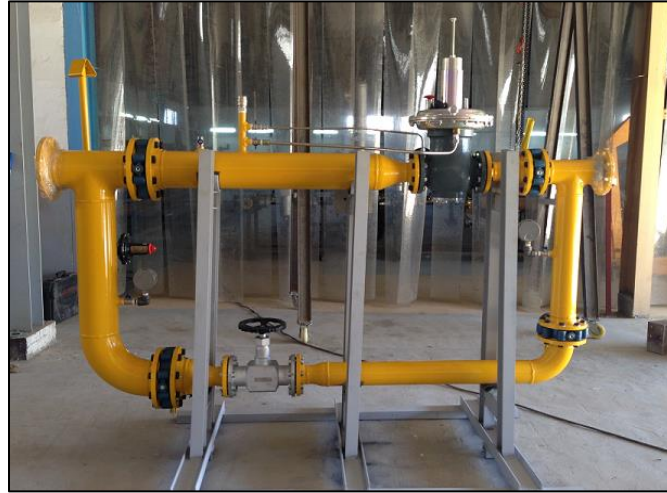
Figure 11: postes de détente haute pression
