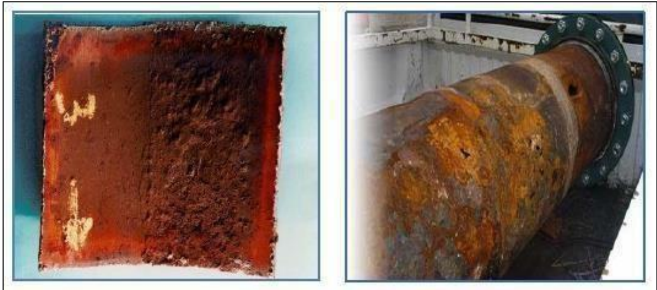
Figure 19: corrosion dans la pipe (a) : internes (b) : externe.
