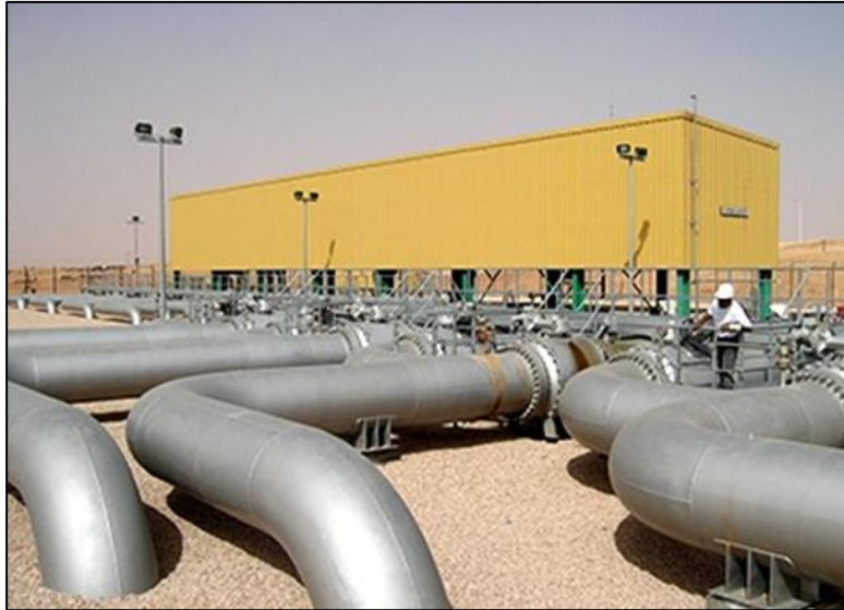
Figure 17 : Une station de pompage
