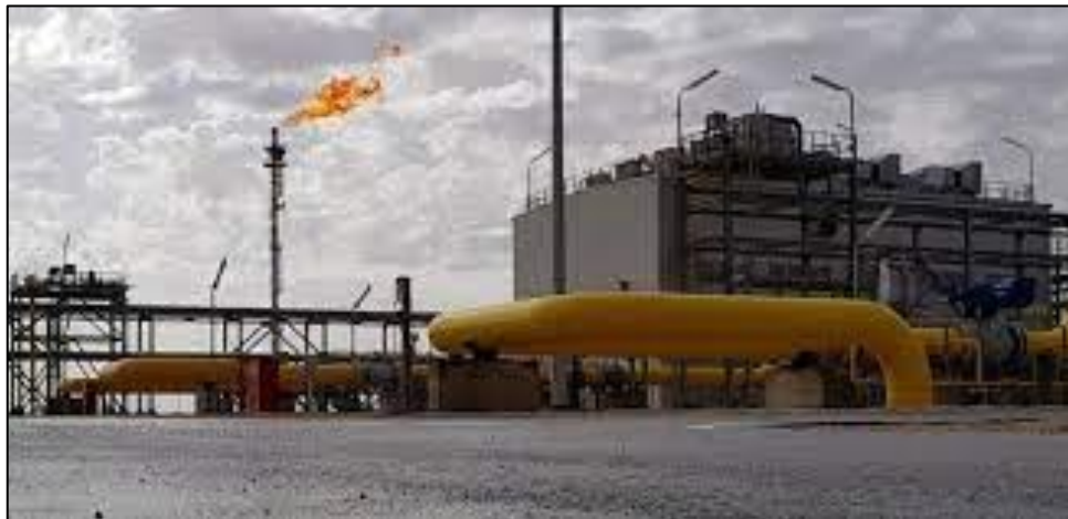
Figure10:stations de compression de gaz
