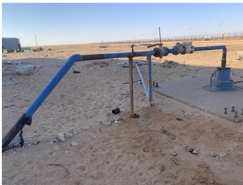
Figure IV.1 : Puits hydraulique du centre de production
