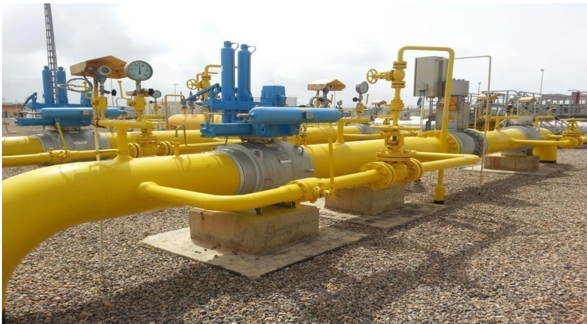
Figure 17: Rampes de régulation
