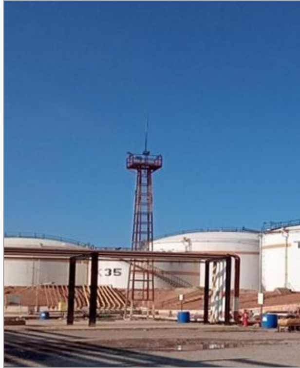
Figure II. 10 : Modèle de paratonnerre utilisé dans le centre de distribution de carburant
