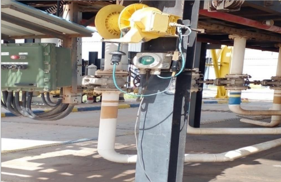
Figure II. 7 : Dispositif de mise à la terre dans une poste de chargement
