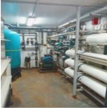
صورة(14): محطة تصفية المياه. 2019
