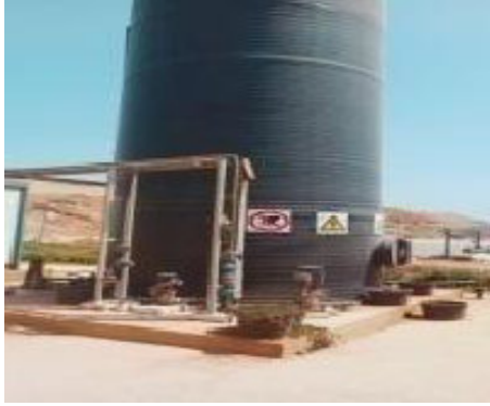
صورة (12): خزان تجميع و ترشيح العصارة 2019
