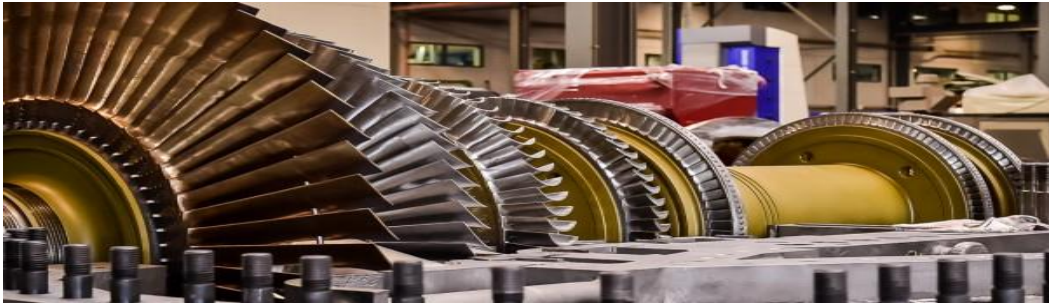
Figure 1.6 : Turbine à vapeur
