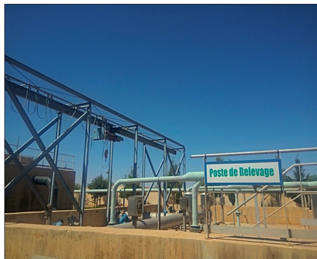
Figure III.10. Poste de relevage du step d'Ain Sefra.
