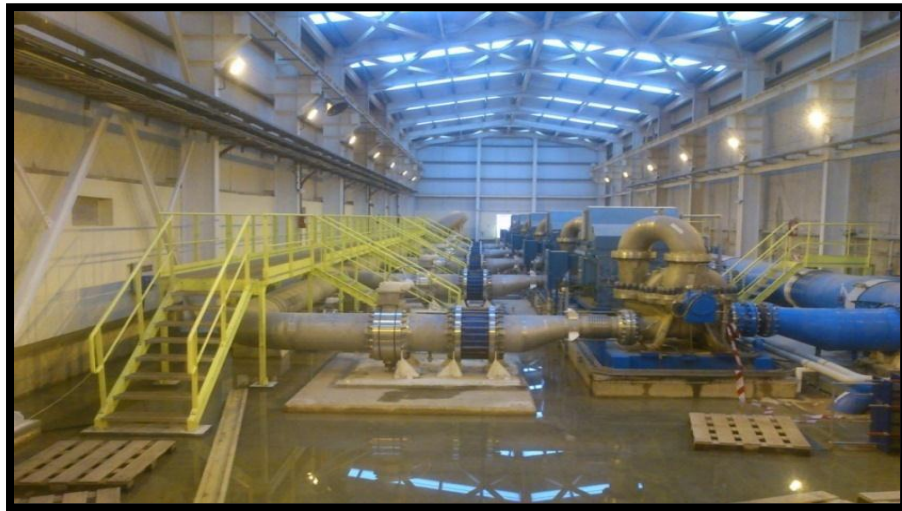
الصورة رقم 10: محطة الضخ للمياه المنتجة
