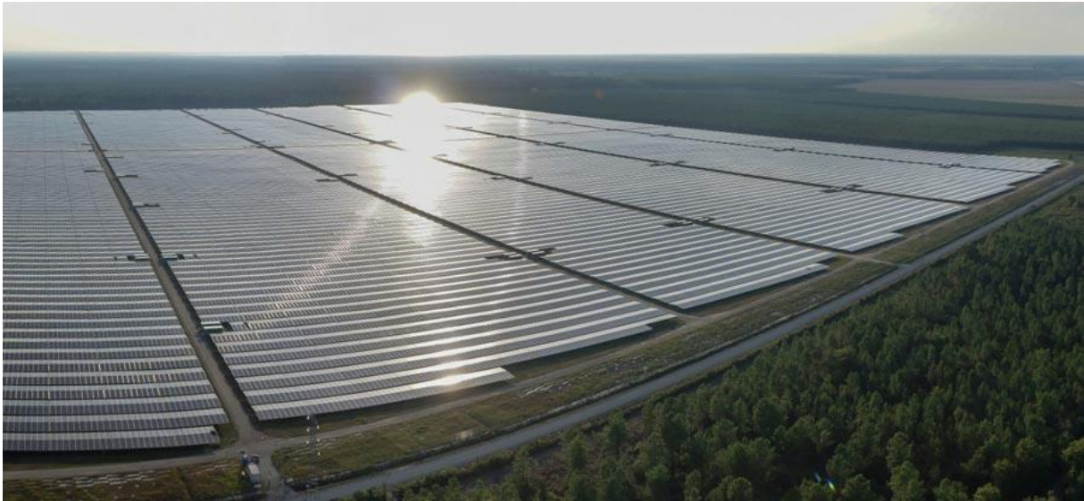
Figure II.2 : La centrale solaire de Bordeaux.
