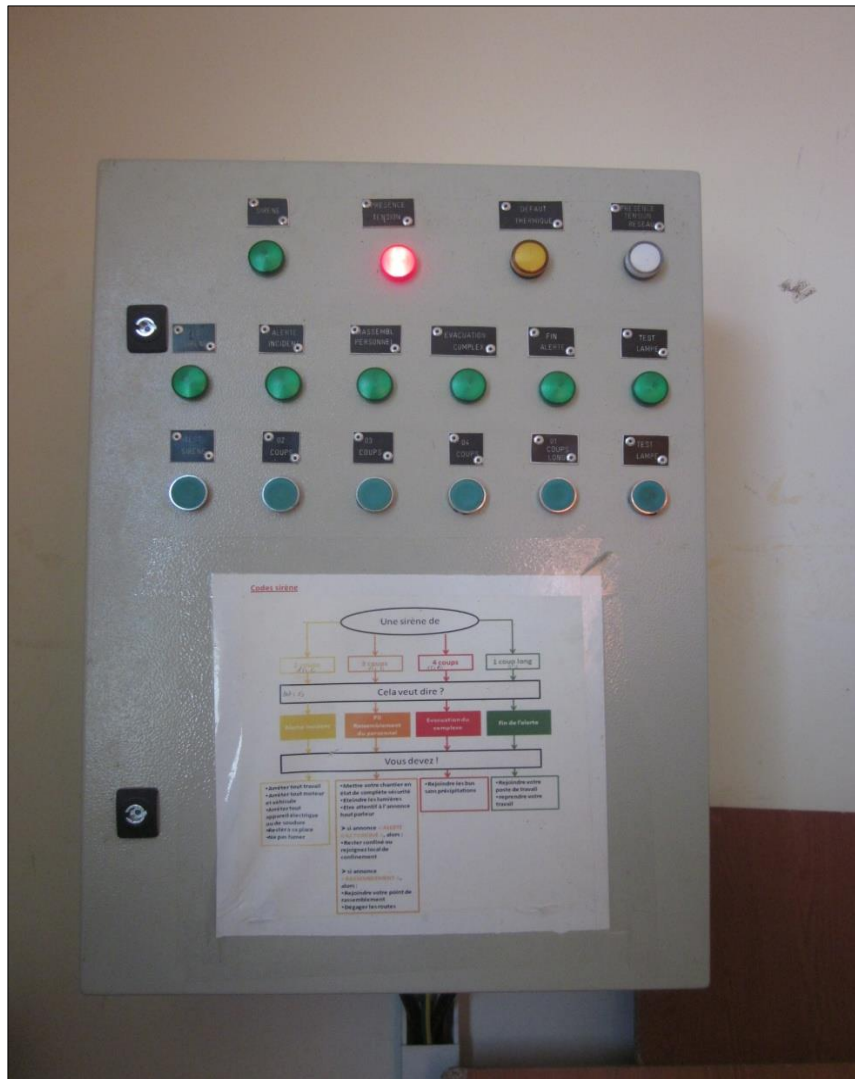
Figure I.10 : Armoire de commande.
