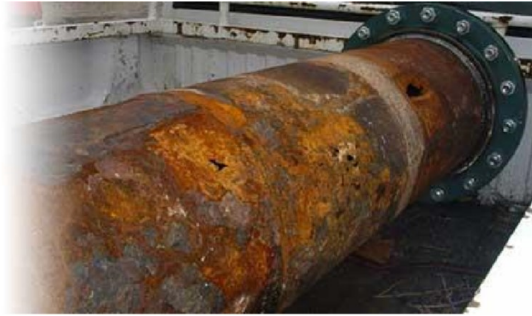
Figure (I-13) : Corrosion externe dans une pipe
