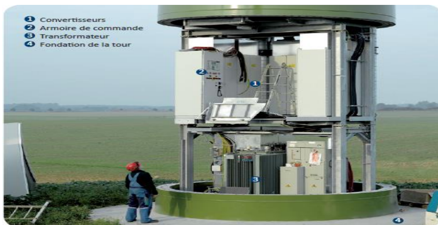
Figure I.17. Cabine de dispersion située au pied de la tour [25].
