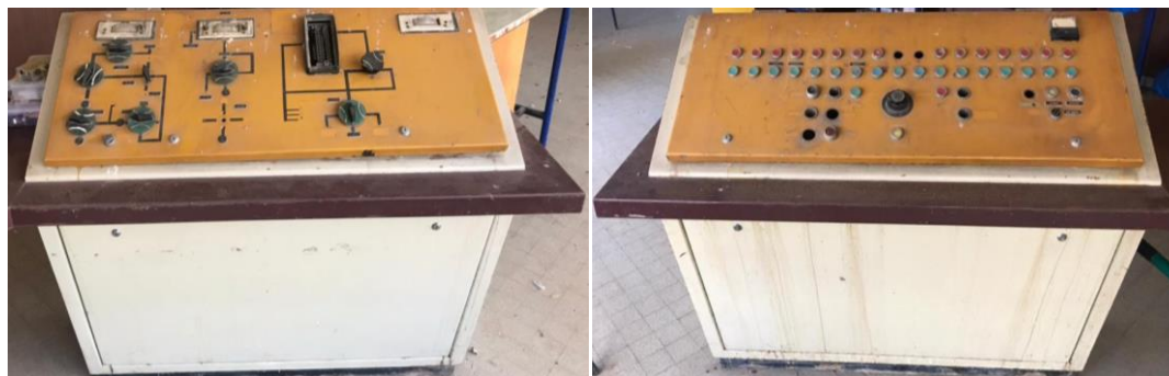
Figure IV.17. Pupitre de commande à gauche pour le contrôle de la chaudière et à droite pour contrôler les unités de régulation, unités : 000, 100, 200 et 3
