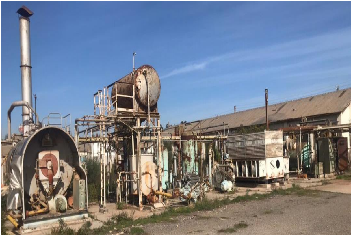
Figure IV.15. Vue de l'unité 500, la mini-centrale thermique d'UPCA
