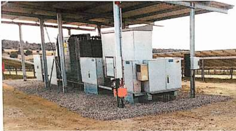
الصورة رقم 02 الجزء SKID
