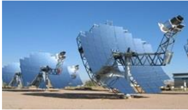
Figure.II.6. centrale à capteur parabolique
