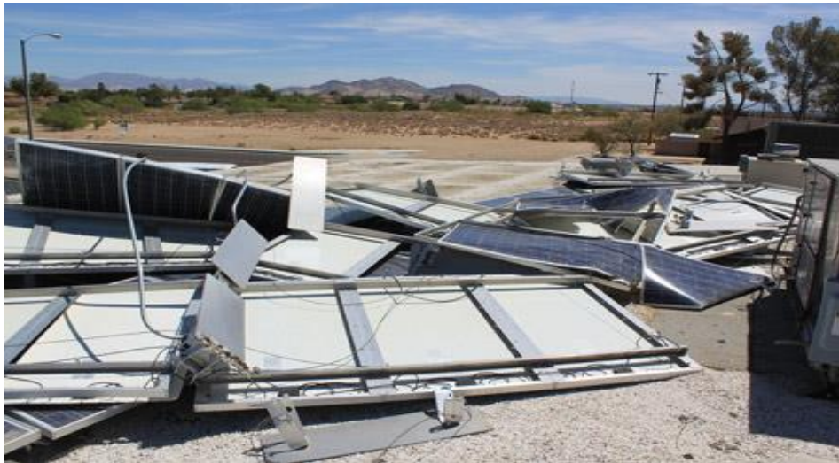
Figure.III.5.Héliostones endommagés par le vent
