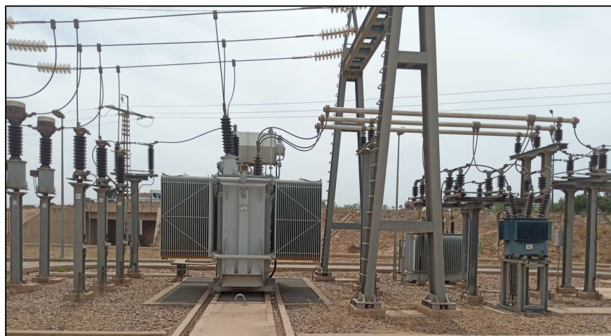
Figure II.1.2.3 - Transformateur 60 /30kv – Transformateur 30KV/400 V
