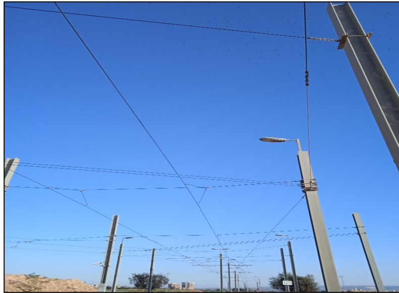
Figure I.7.1 - Ligne aérienne de contact
