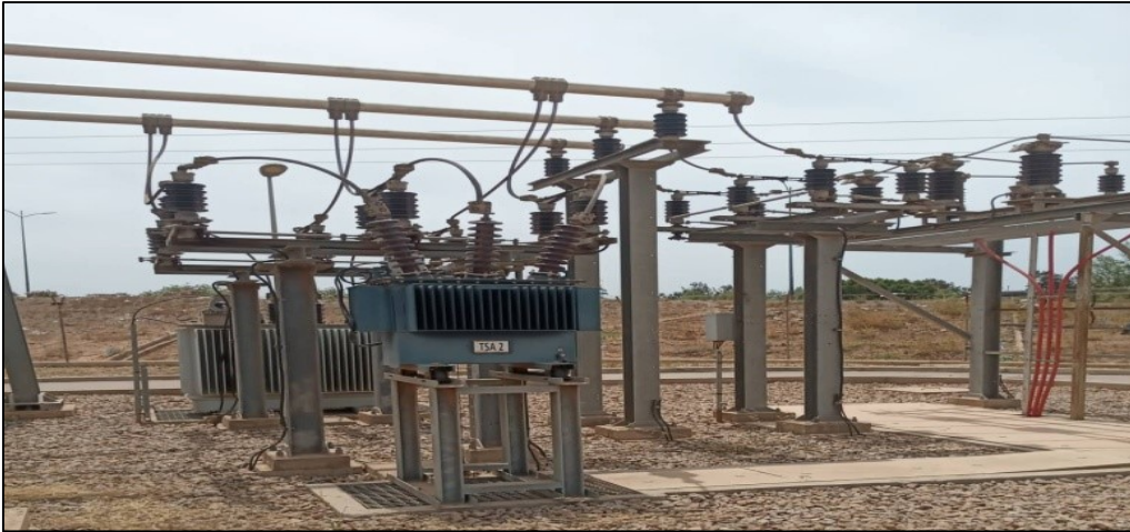
Figure II.2.26 - Transformateur de Service Auxiliaires
