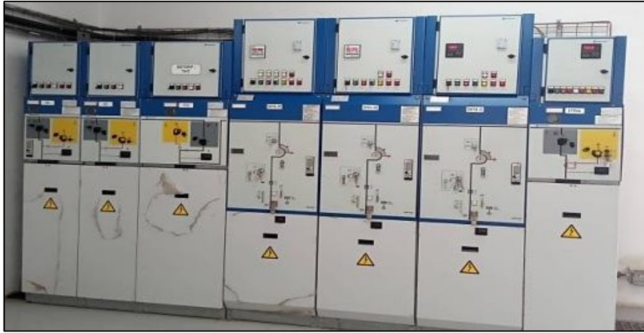
Figure II.2.3 - Tableau 30kv de la sous-station dépôt
