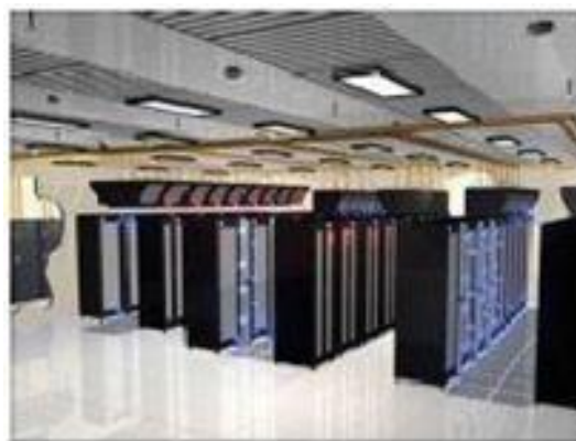
Figure I.5 : installation électrique et électronique
