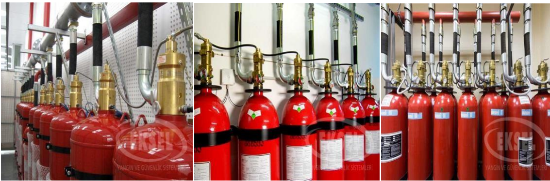
Figure II. 5 : Système automatique de détection-extinction par FM200
