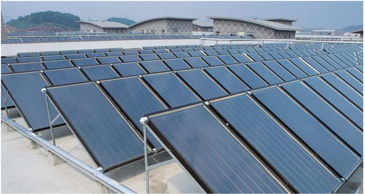
Figure I-8 Une installation des capteurs plans
