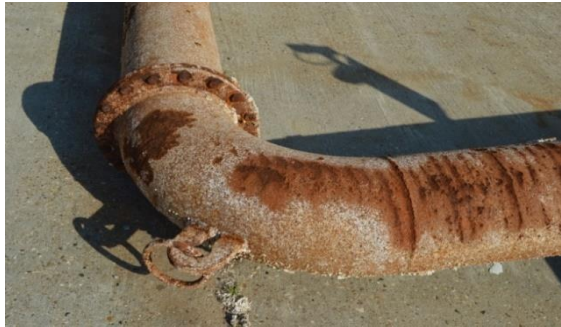
Figure 1-14 Corrosion Externe d'une pipe
