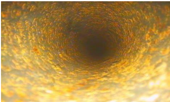
Figure 1-15 Corrosion Interne d'une pipe
