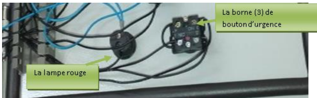
Figure 3.28 : Raccordement entre le bouton d'urgence et sa lampe.
