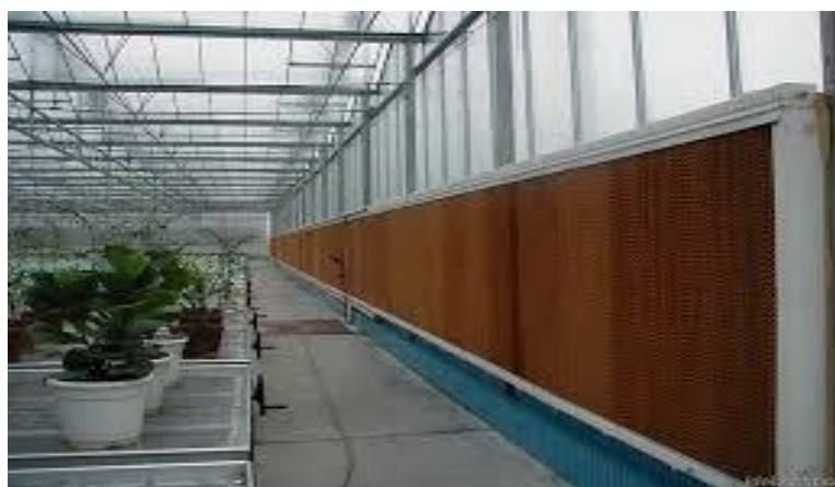
Figure I. 14: Panneau de refroidissement "Cooling Pad"
