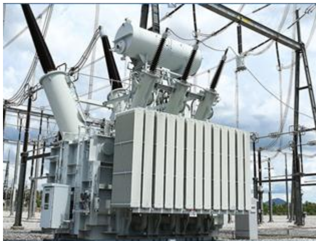
Figure I. 5: Transformateur de puissance.
