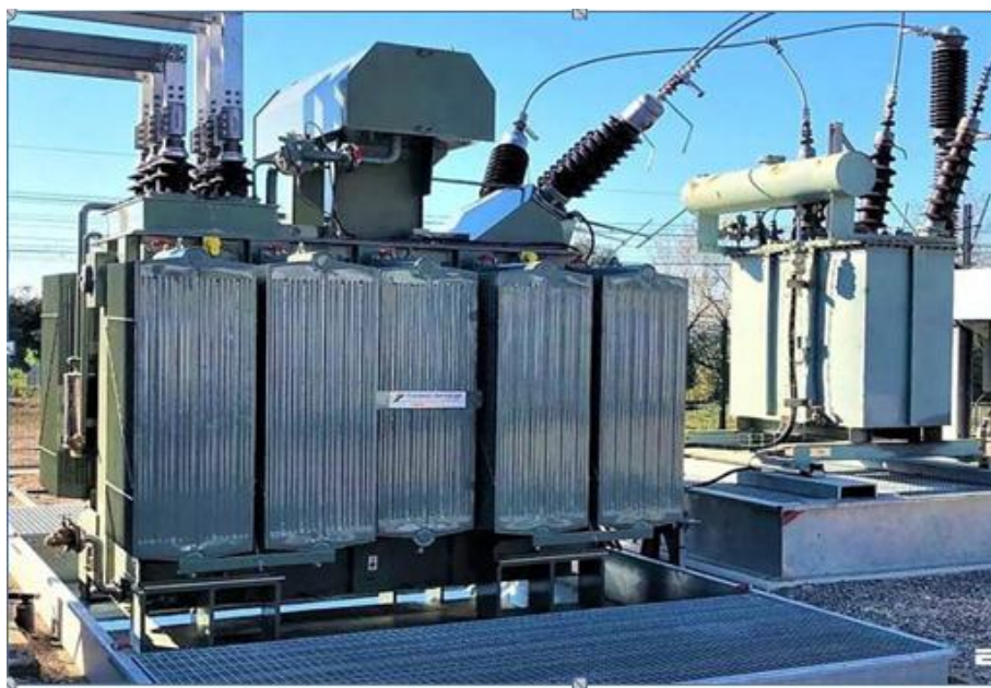
Figure I. 4: transformateur de distribution
