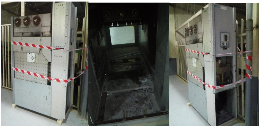
Figure 0.1: Photos pour une cellule HTA brûlée au niveau de KNAUF
