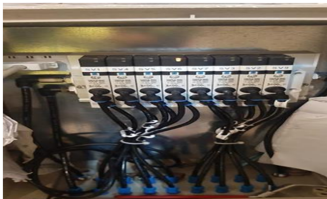
Figure 17 : les convertisseurs électropneumatiques de filtre
