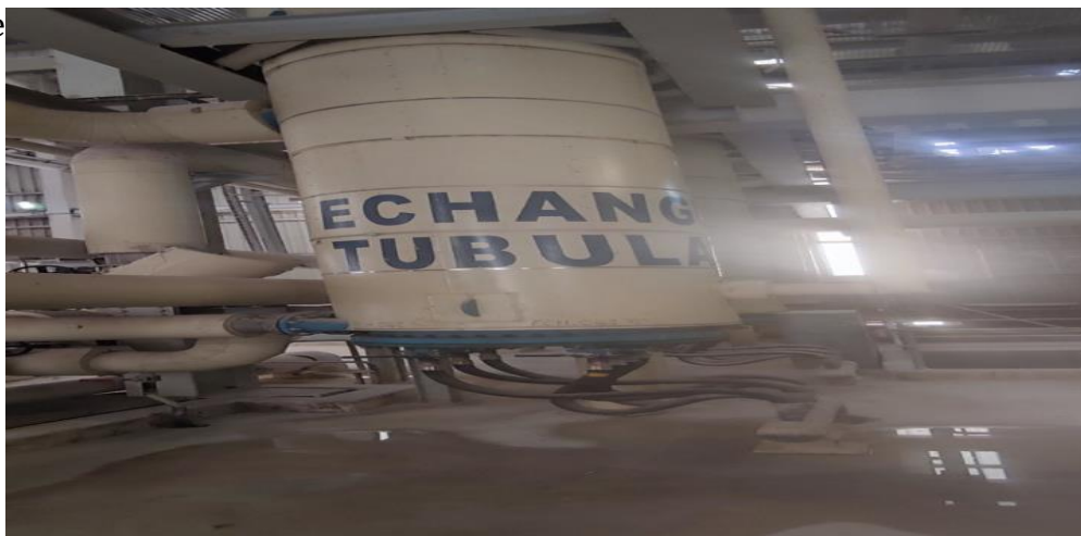
Figure 5:échangeur de carbonatation
