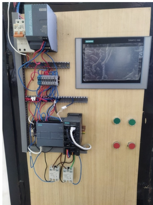
Figure 44. Tableau électrique de la machine.
