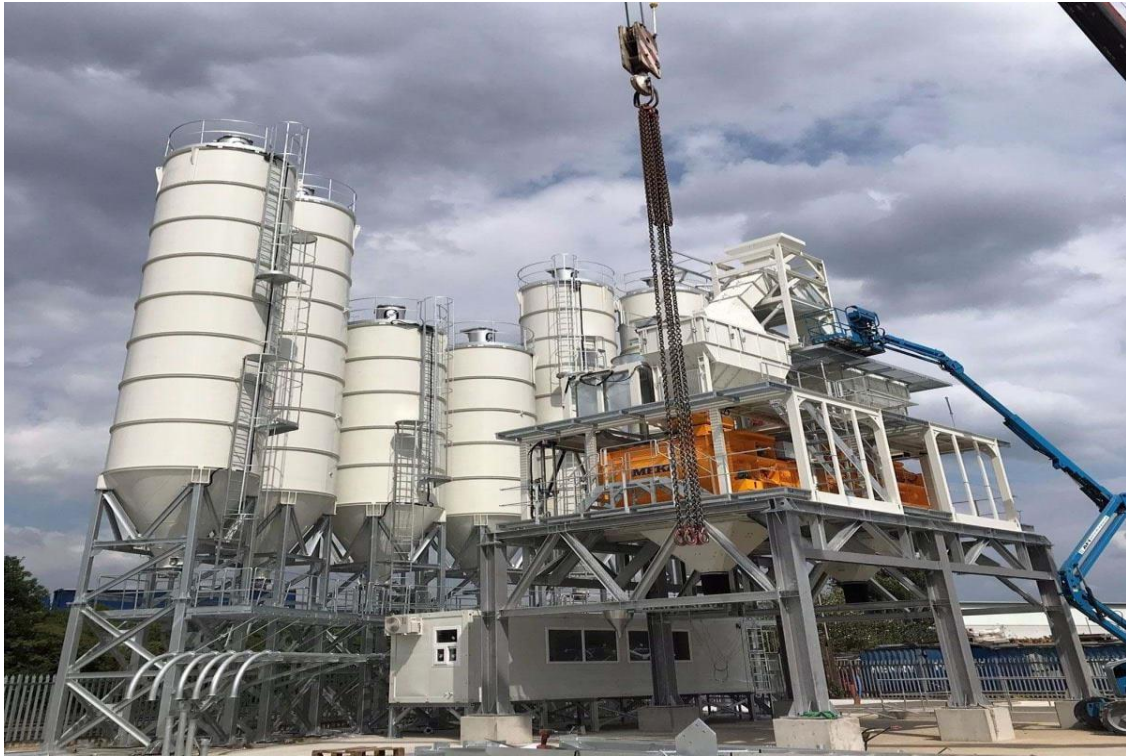
Figure 7 : Centrale à béton humide.
