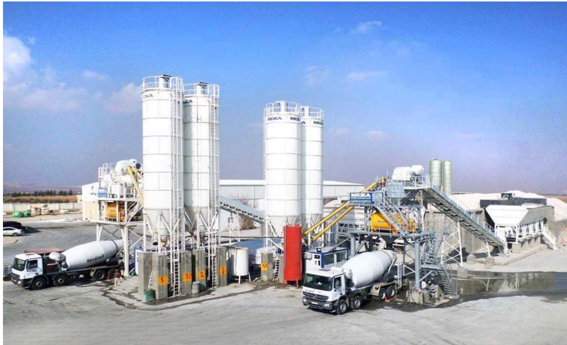
Figure 2 : Centrale à béton fixe.
