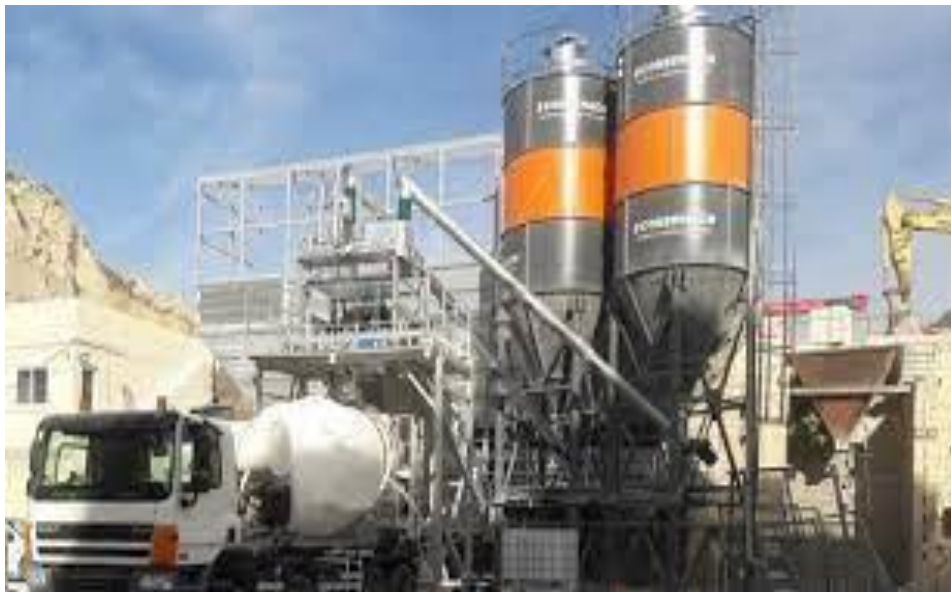
Figure 6 : Centrale à béton sec.
