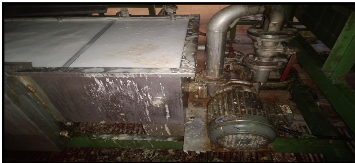
Figure III-3 : pompe de coagulant
