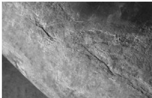
Figure 6 : Agressions corrosives sur la paroi externe d'une canalisation métallique.
