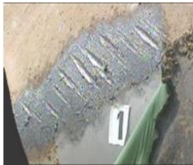
Figure 4 : Exemple de pipeline contenant une entaille
