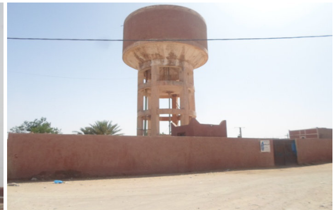
صورة 21: توضح خزان برقع 350 م 3
