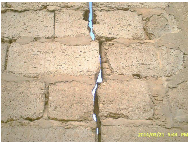
الصورة (55): تشقق عمودي في جدار حديث البناء (لنصاري - مارس 2014)
