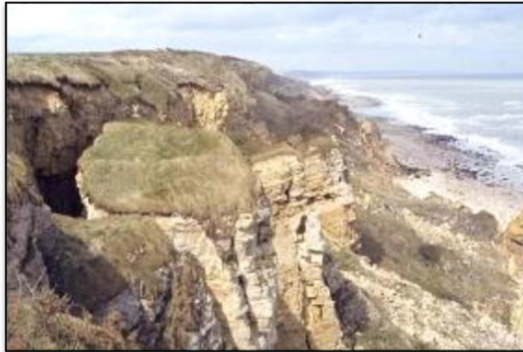
Figure 16 : Basculement corniche calcaire lié au fluage des marnes sous-jacentes, falaises du Bessin de Calvados, in (Achour 2017).
