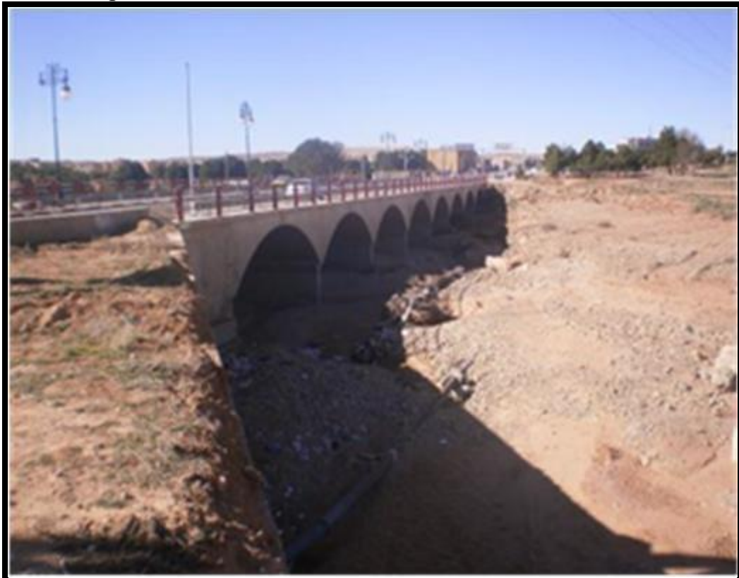
Photo3 : Pont menant vers Tiaret entrée de la ville avec une conduite d'AEP
