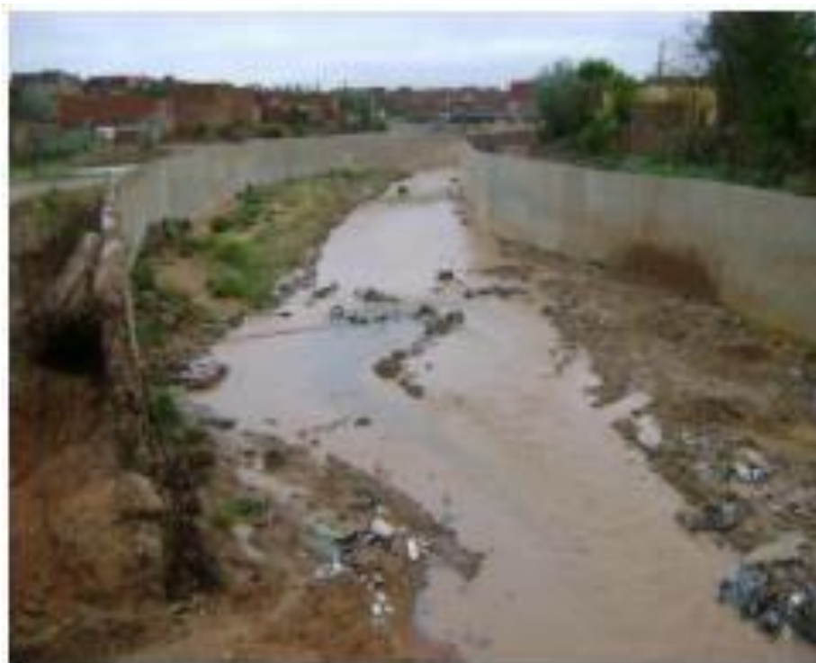
Photo 7 : Oued Deffa avec les voiles de protection en partie détruits
