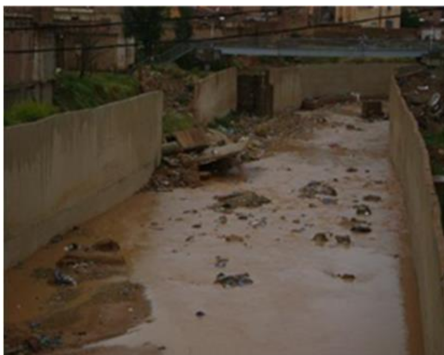
Photo 8 : Oued Deffa avec les voiles de protection en partie détruits
