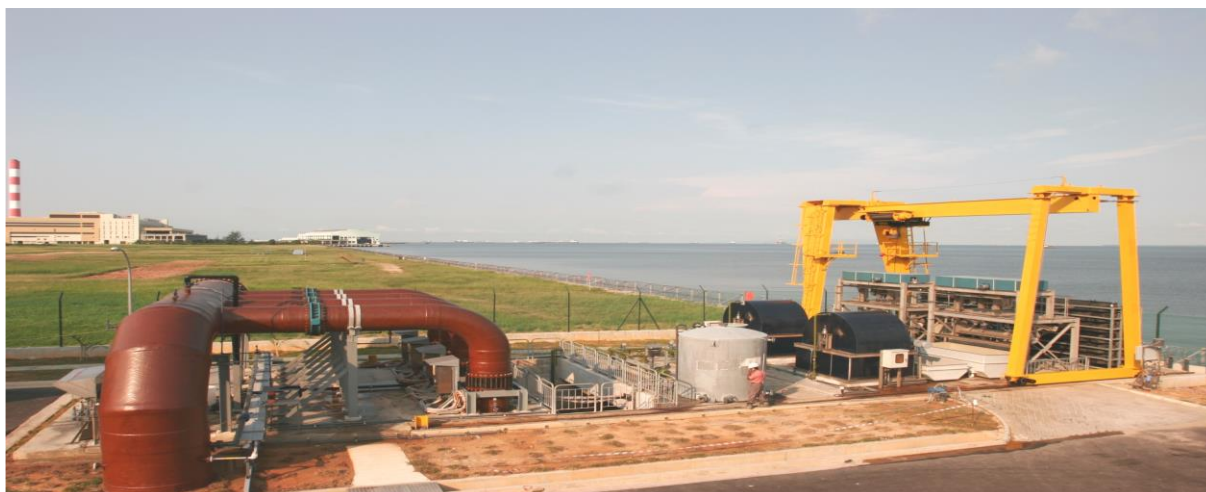
Figure N°12: bassin de réservoir l'eau d' mer et le filtre rotative accoté des filtre TBS et les Cinq pompe
