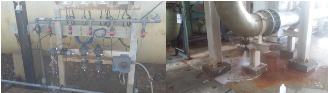
Figure N°16 :poste de prélèvement eau de mer Figure N°17 :poste de prélèvement RO
