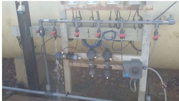
Figure N°18 : poste de prélèvement de l'eau traitée
