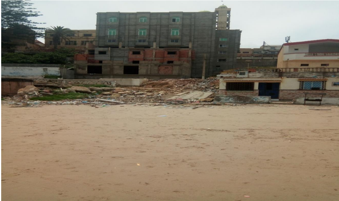
Photo3 : Effondrement d'un mur d'habitation Ain El Türk2.06.2018
