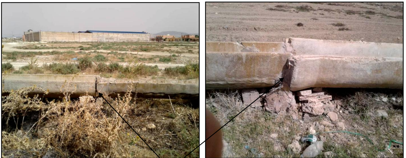
La Rénovation d'une fissure d'un canal tertiaire par cimentation (Cliché BENSELIM, juin 2018)
