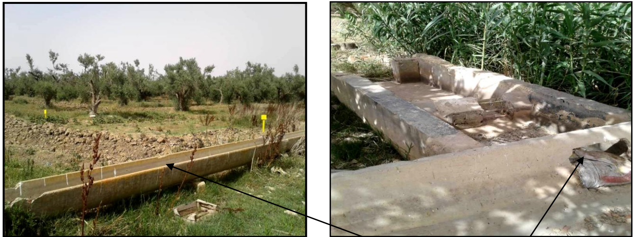
Photo.10 : Cité Kharouba commune de Sig, canal tertiaire abandonné et détérioré (Cliché BENSELIM, juin 2018)
