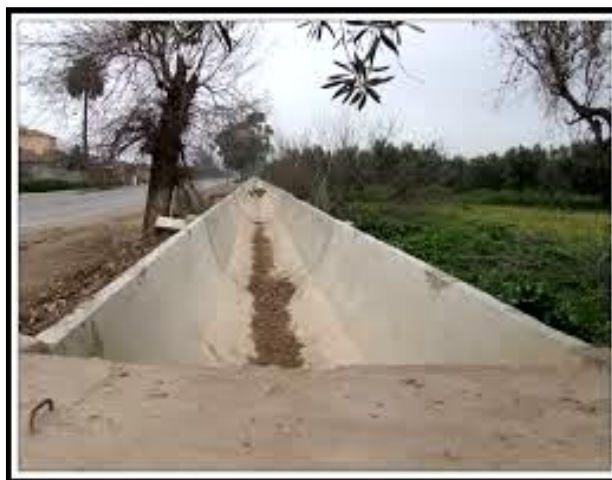
Photo.11 : canal principal vide qui traverse l'agglomération de Sig rempli de matériaux limoneux et argileux
